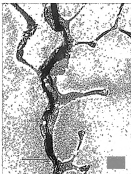
Рисунок А.19 — Трещина волосовидная
