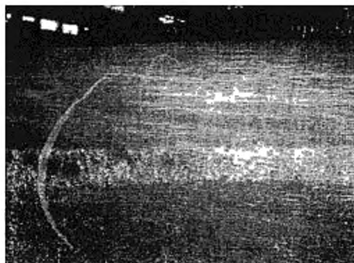
Рисунок А.3 — Трещина поперечная
