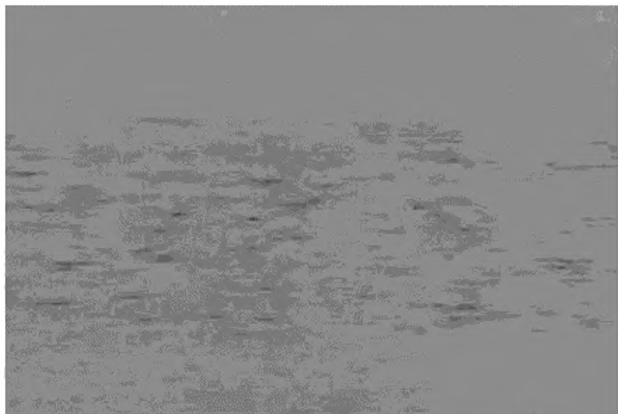
Рисунок А.50 — Пятна под лаковым покрытием
