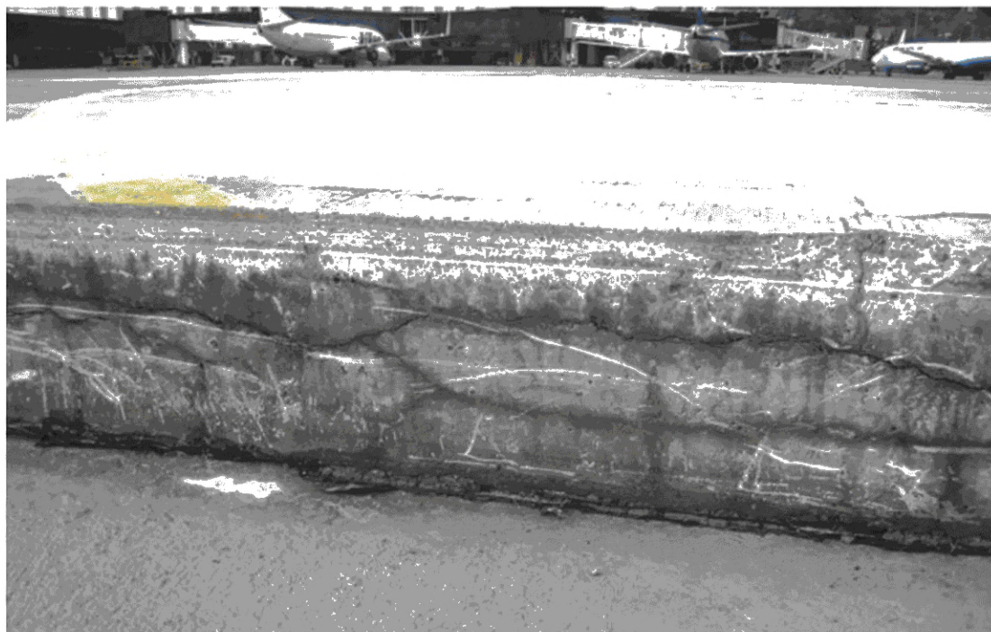
Рисунок 2 — Внутренние трещины, превратившие монолитную плиту в слоистую систему
