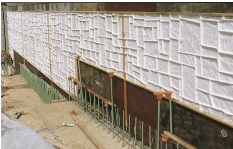
Рисунок 7 – Сборка опалубки с использованием формообразующих элементов, имитирующих поверхность каменной кладки, с использованием рустовочных планок
