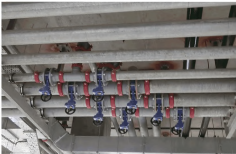
Рисунок 5 – Вид стоянки автомобилей с инженерными сетями (грувлочные соединения)
