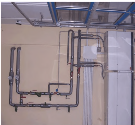
Рисунок 8 – Фрагмент установки воздушно-тепловой завесы
