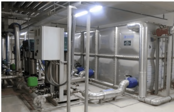
Рисунок 19 – Автоматическая станция пожаротушения с резервуарами воды
