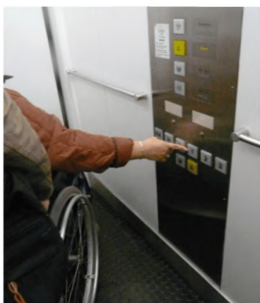
Дублирование панели управления в кабине лифта на высоте, удобной для инвалида в кресле-коляске
