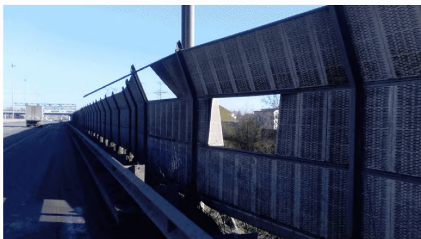
Рисунок А.4 — Типичное разрушение кластерных панелей при обслуживании
