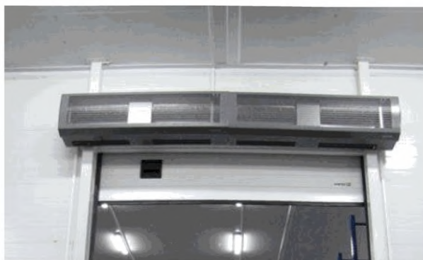
Рисунок 21 – Примеры устройства противопожарных ворот с воздушной завесой со стороны помещения хранения автомобилей посредством настольных воздушных струй от сопловых аппаратов
