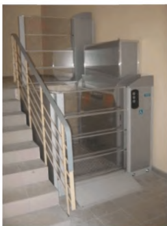
Нижняя площадка платформы вертикального перемещения
