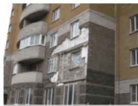
Г. Обрушение облицовочного слоя на фасаде здания
