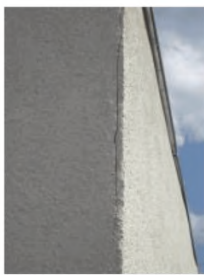
Д. Вертикальные трещины в штукатурном слое
