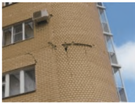
А. Трещины в облицовочной кладке на фасадах
