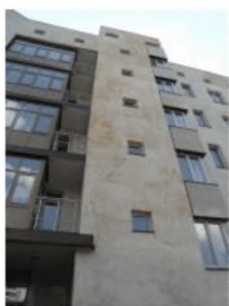
Ж. Повреждения штукатурных поверхностей на фасадах
