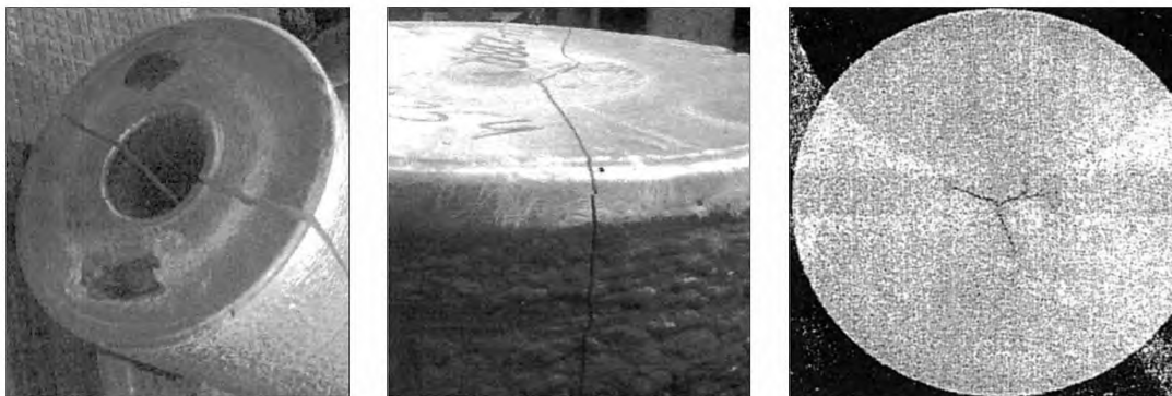
Рисунок А.6 — Трещина центральная
