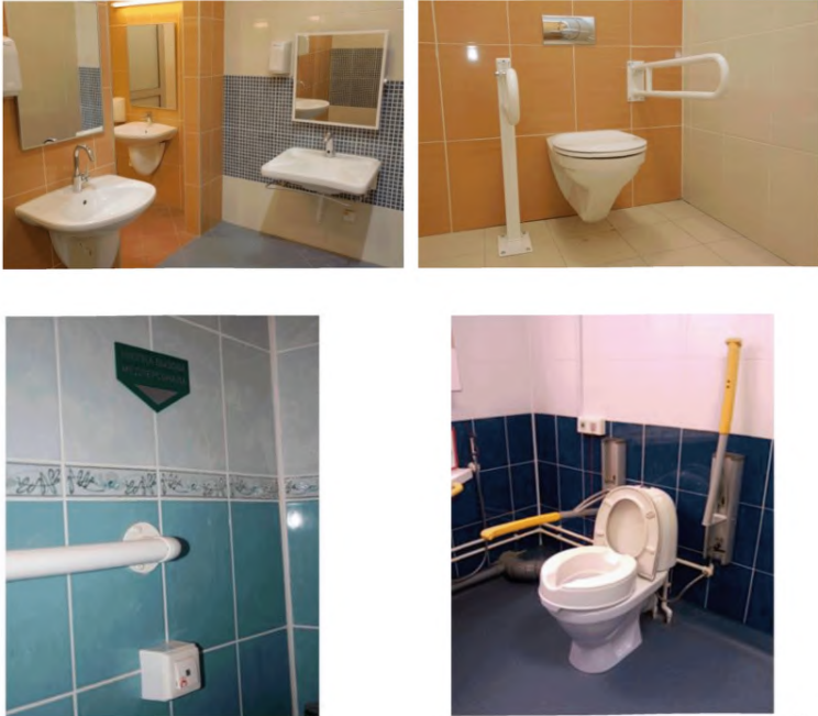
Примеры оборудования санитарно-гигиенических помещений 41
