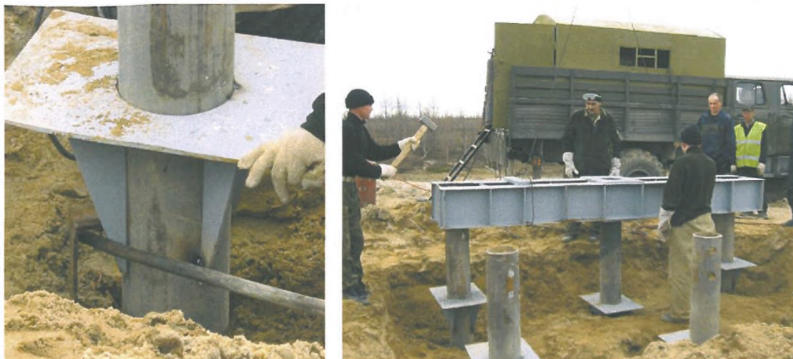
Рис.2.10 - Выполнение прихваточных сварных швов; установка балок нижнего уровня ростверка (на заднем плане – двухкабинный Урал 4320-31 с дизельным сварочным агрегатом АДД для сварки в полевых условиях)
