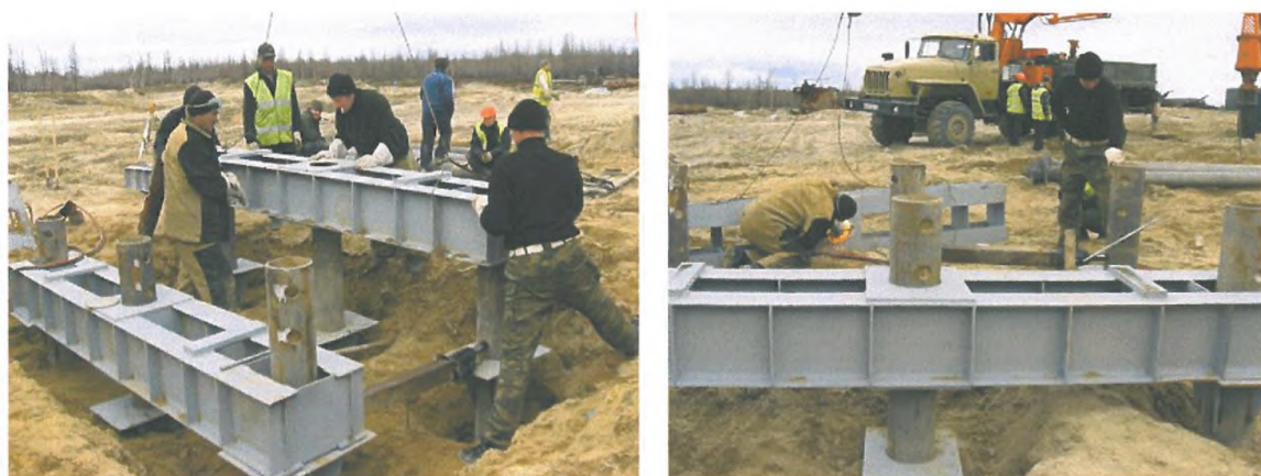
Рис.2.11 - Установка балок нижнего уровня с использованием домкратов; подгонка элементов балок при помощи газовой резки.
