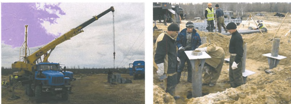
Рис.2.9 - Погрузочно-разгрузочные работы (перемещение нижних балок ростверка); выполнение земляных работ, задание проектной вертикальной отметки, установка опорных столиков и закрепление их к сваям прихваточными сварными швами
