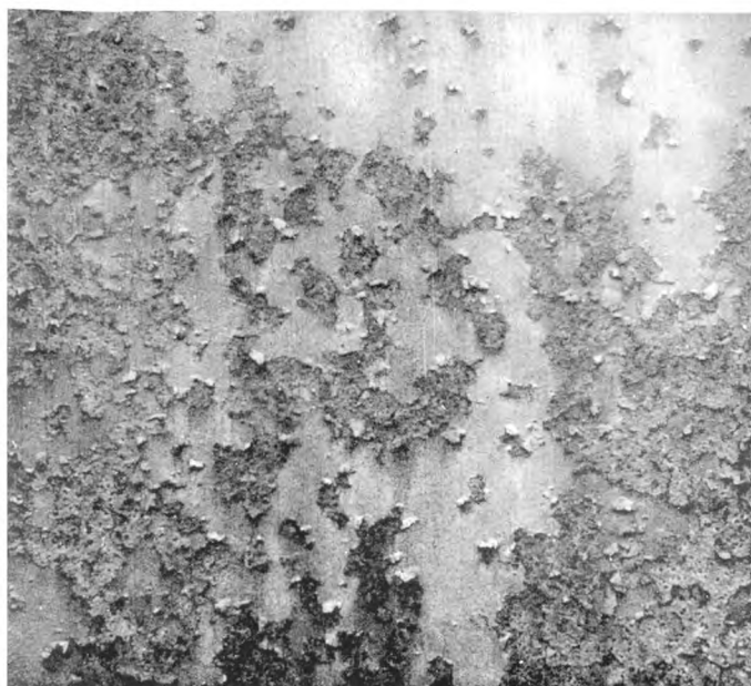
Рисунок 13 — Коррозия металла балл K5 (или R/5)
