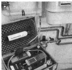
Проведение предварительных тестов с использованием прибора testo 312-3
