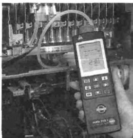
Испытание на герметичность с использованием прибора testo 312-1/2
